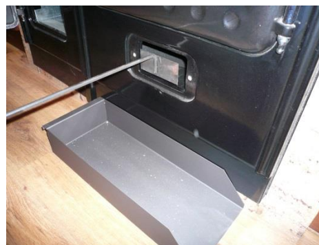
Figura n.º16 - Acessos para a limpeza da saída de fumos.
